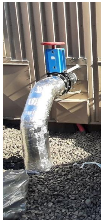
Рисунок 16. Теплоизоляция трубопровода отбора
