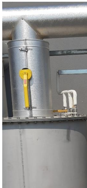
Рисунок 21. Защита от замерзания газопровода и трубопровода анализируемого газа
