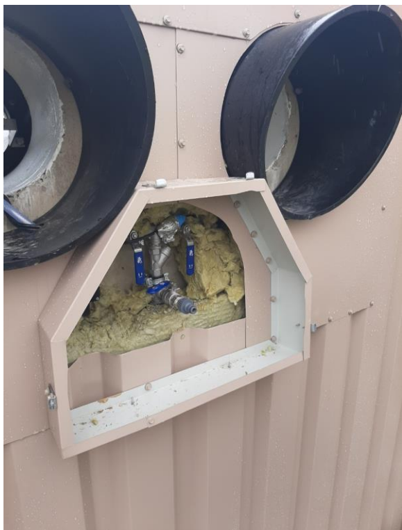
Рисунок 17. Теплоизоляция и сопровождающий обогрев трубопровода воды
