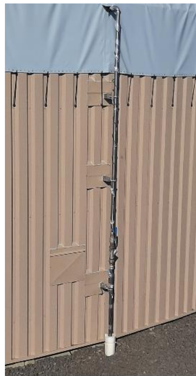
Рисунок 14. Сопровождающий обогрев трубопровода подачи конденсата
