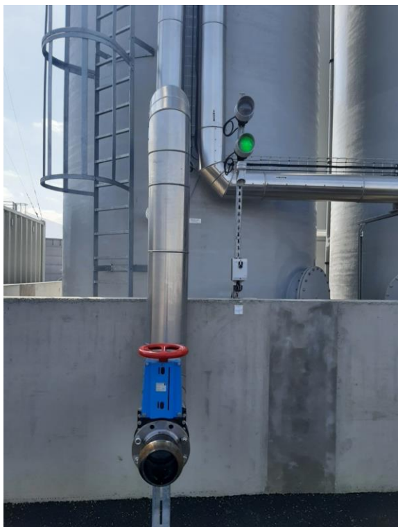
Рисунок 20. Защита от замерзания трубопровода отбора жидких субстратов
